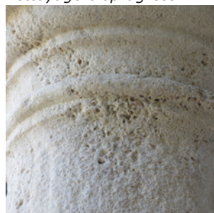
Pierre émoussée par un nettoyage trop agressif
