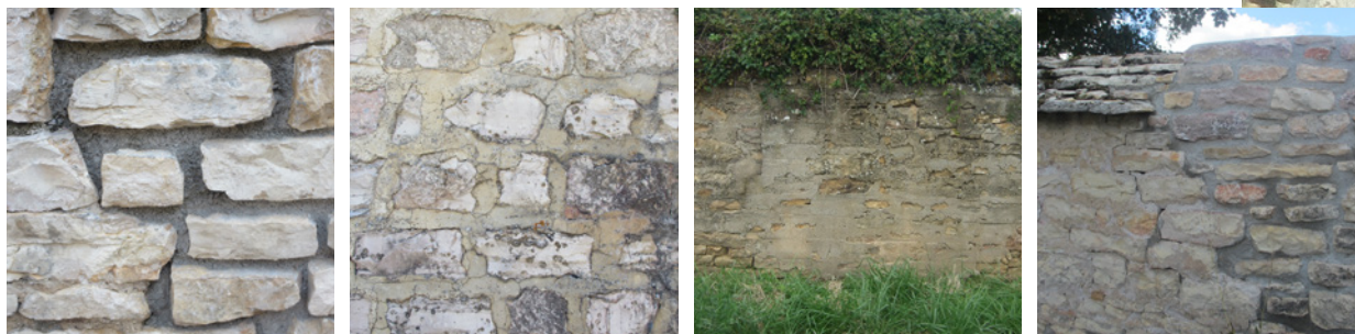
Reprises diverses de joints : au ciment, en surépaisseur ou avec des matériaux disparates
